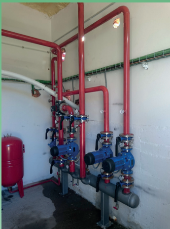
COLECTOR SIN AISLAR
